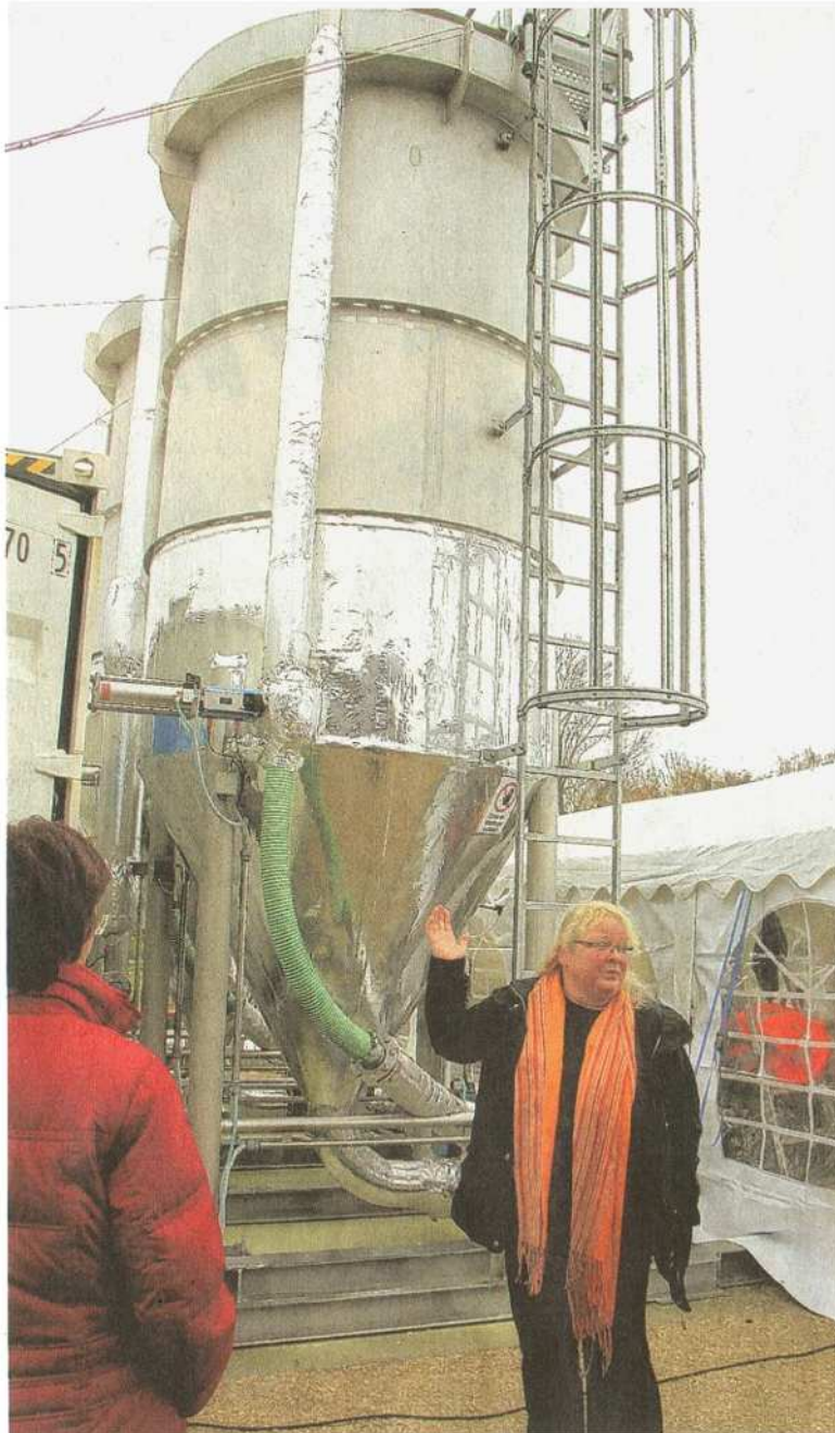
Susanne Kimmich (rechts), technische Leiterin der Firma Epuramat, zeigt die beiden ExSep-Silos, so der Name der Reinigungsanlage, in denen das Wasser vorgeklärt und von Sand und Fett befreit wird. Foto: Manfred Dittenhofer
